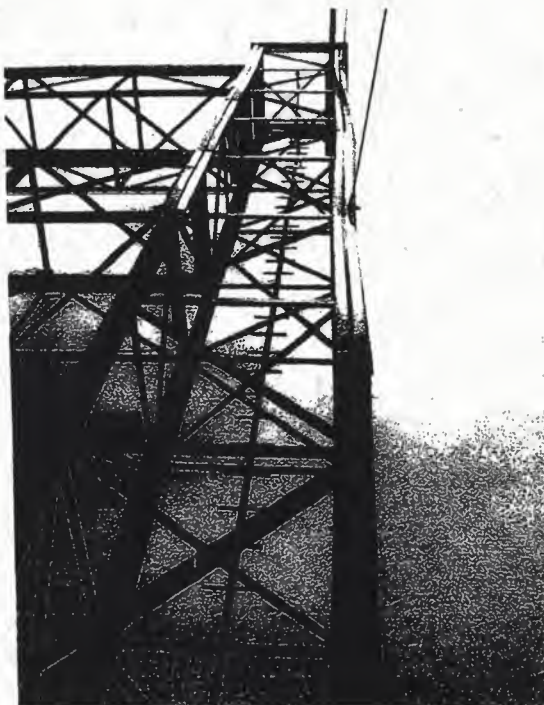
Foto 06 – Estrutura do pórtico desalinhada por conta dos esforços e amarrações existentes.
