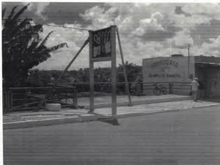
Figura 10 – Falta do perfil de estabilização do tirante de fibra de carbono (iluminação)
