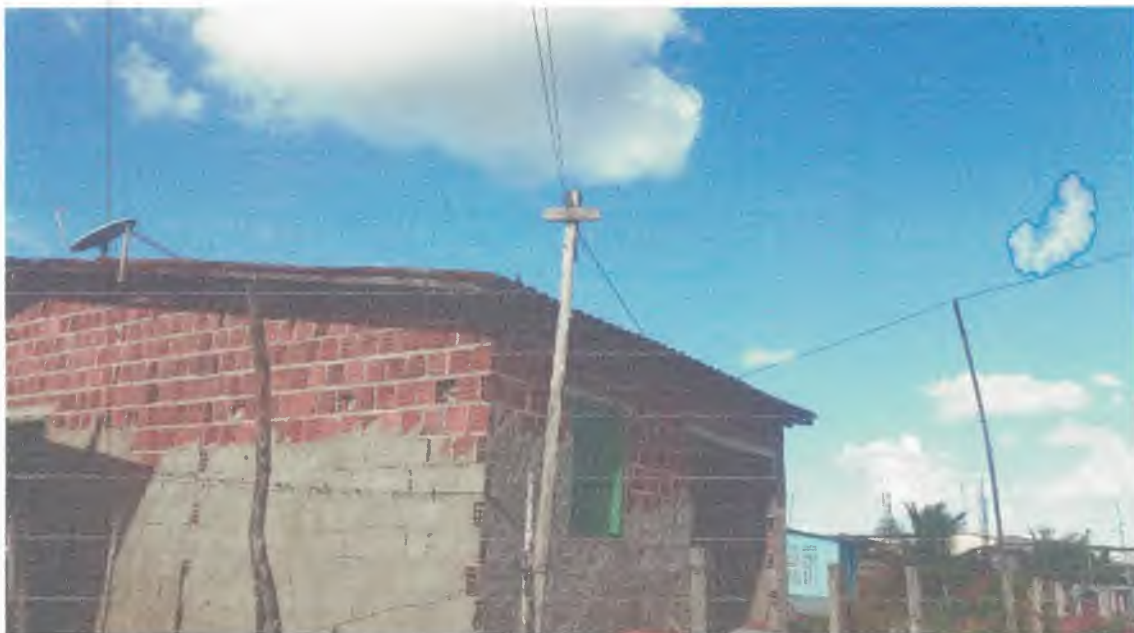
Postes Improvisados pela própria comunidade
