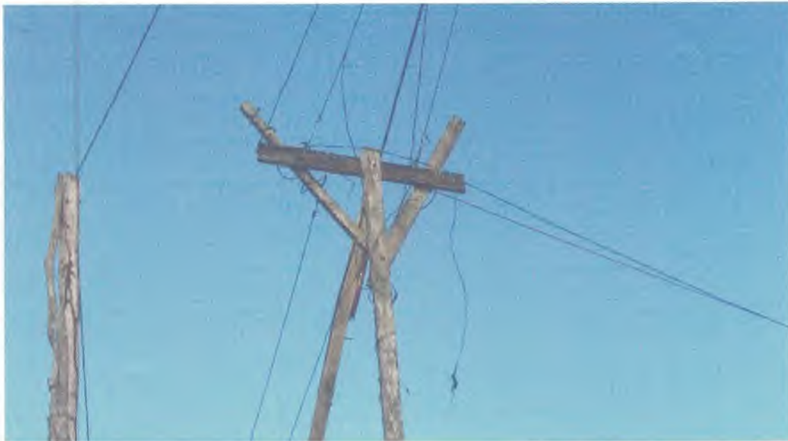
Postes Improvisados pela própria comunidade
