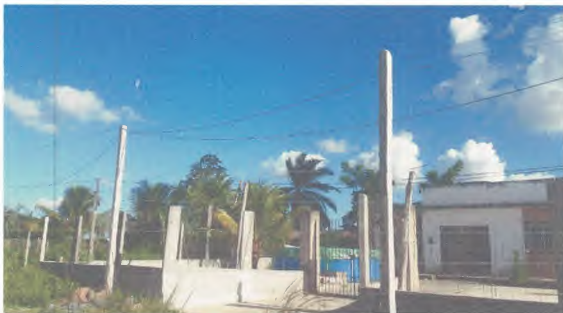
Postes Improvisados pela própria comunidade
