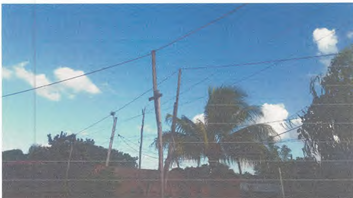
Postes Improvisados pela própria comunidade
