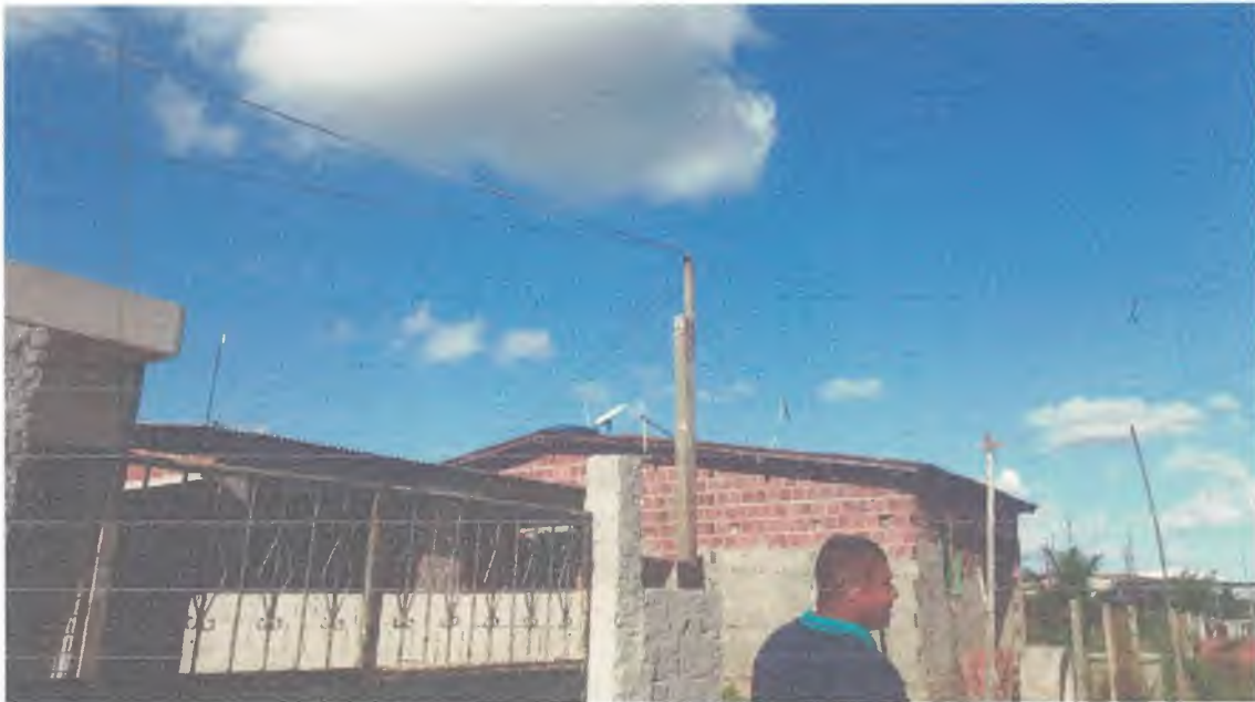
Postes Improvisados pela própria comunidade
